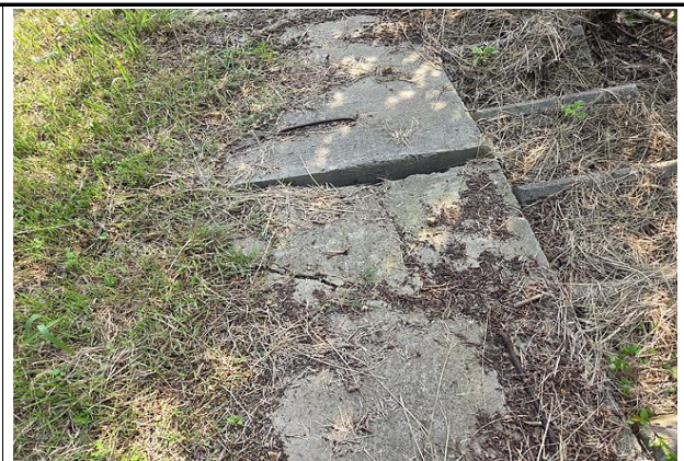
산마루측구 덮개 파손
