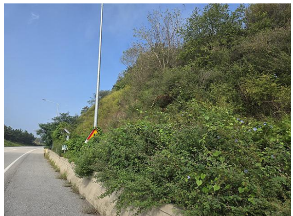
도로부, 낙석방지울타리 전경
