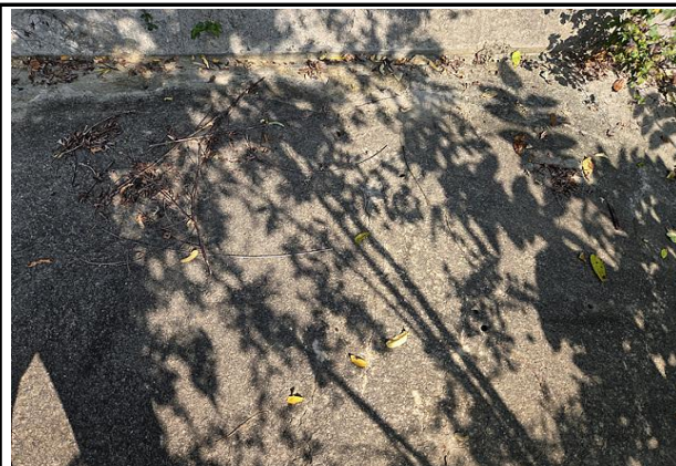
1소단배수로 균열, 토사퇴적
